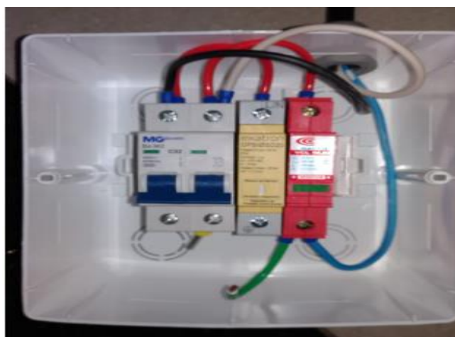
FIGURA 32– INTERIOR DA STRING BOX CA
