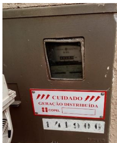
FIGURA 47– PLACA DE ALERTA NO MEDIDOR DE ENERGIA
