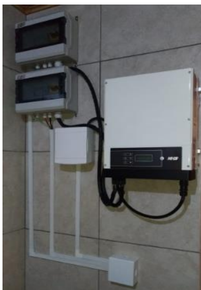
FIGURA 46– PROTEÇÃO E INVERSOR
