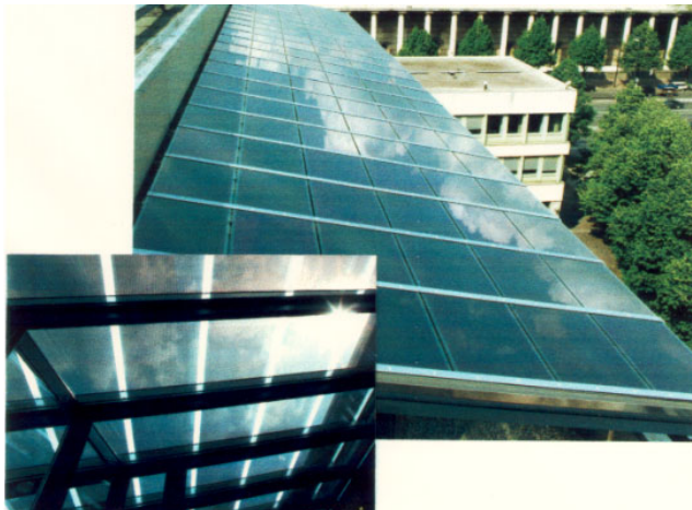
Figura 38: Aplica  o de m  dulos solares de filmes finos de sil  cio amorfo (a-Si) semitransparentes   cobertura de uma edifica  o comercial. Neste caso uma fra  o de luz   admitida ao interior da edifica  o promovendo a utiliza  o de ilumina  o natural ao mesmo tempo em que uma fra  o da energia utilizada para atender ao consumo das instala  es do pr  dio   gerada in situ [Phototronics Solartechnik GmbH].
