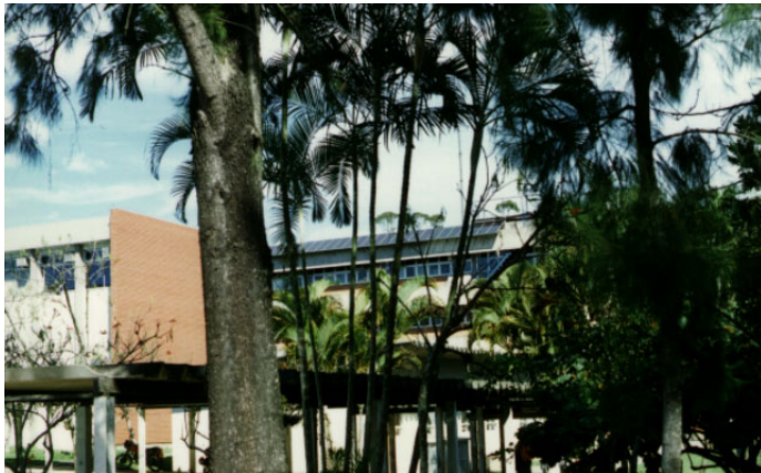
Figura 19: Sistema solar fotovoltaico de 2\text{kWp} instalado na UFSC em Florianópolis. A superfície de \sim 40\text{m}^2 apresenta uma inclinação de 27^\circ e está orientada para o norte geográfico.
