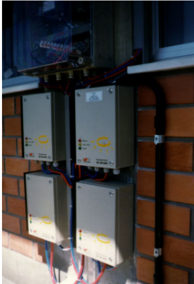
Figura 21: Os quatro inversores Würth (650W cada) que compõem o sistema de 2kWp instalado na UFSC.
