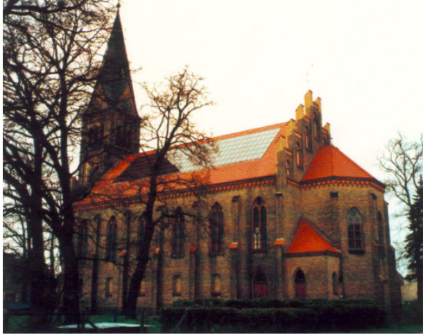
Figura 33: Instalação fotovoltaica integrada ao telhado de uma edificação centenária. Neste caso o sistema foi instalado de forma integrada quando da renovação do telhado desta igreja [Photronics Solartechnik GmbH].
