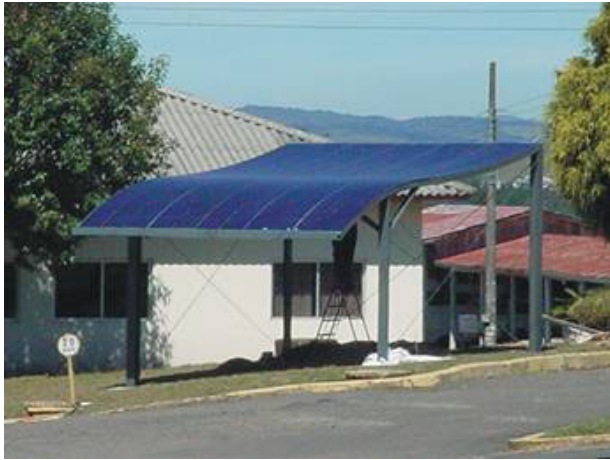
Figura 26: Módulos solares fotovoltaicos do tipo flexível, colados diretamente sobre superfícies curvas de uma cobertura metálica em forma de onda. Projeto LABSOLAR / CEESC. Foram instalados três sistemas como o desta figura em Florianópolis, Lages e Tubarão – SC, com 1.4kWp cada.
