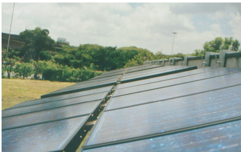
Figuras 23: Pr dio do IEE/USP, com a integra o de 12kWp de m dulos fotovoltaicos em sistema interligado   rede el trica [Zilles & Oliveira, 2001].
