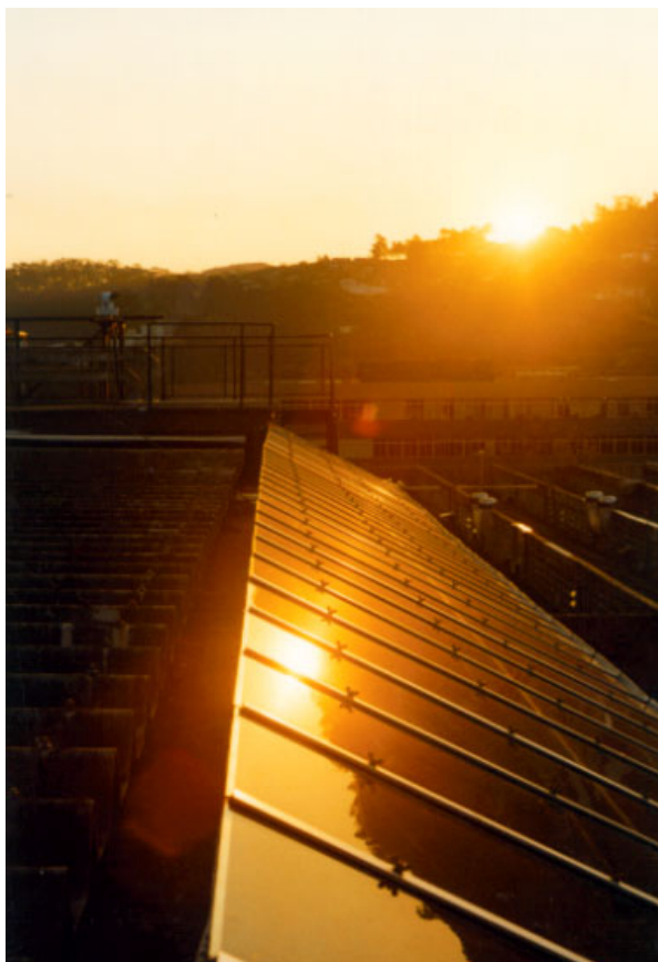
Figura 20: Vista ao por do sol do sistema instalado junto ao LABSOLAR/UFSC. A instala o solar fotovoltaica recebe a luz solar sem sombreamento por obst culos desde as primeiras horas da manh  at  o final da tarde.
